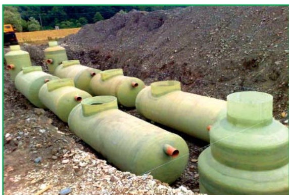
Дорога «Адлер-Альпинка». Временный поселок строителей. Ливневые очистные сооружения «ЮНИЛОС», производительность 30 л/с
