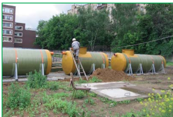
Московская область. Коттеджный поселок. Ливневые очистные сооружения «ЮНИЛОС», производительность 10/30 л/с
